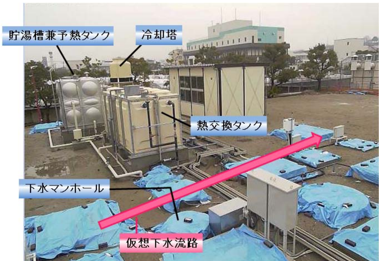
下水熱利用・融通技術 実証試験設備
